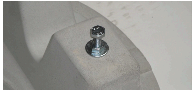
Abb. 12: Schraube in Bodenplatte
