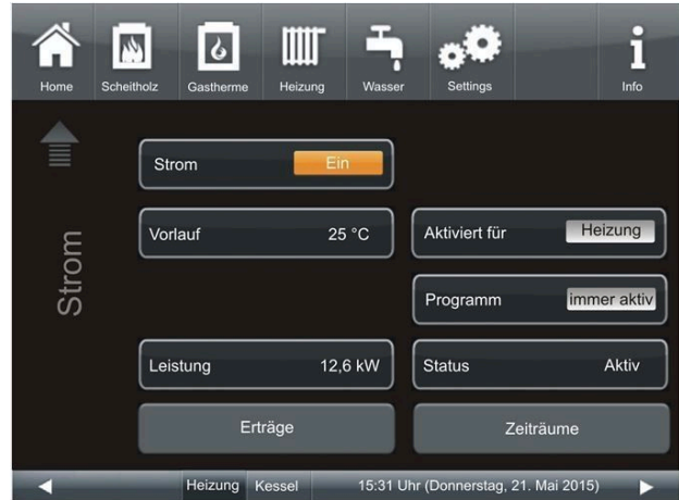
Abbildung 4: Menü ZH 2 (2. Seite) mit EWP-Leistung für Stromheizung (ZH 2)
